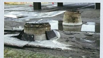
写真 マンホールの浮き上がり状況 (千葉県浦安市) [朝日新聞HPより]
