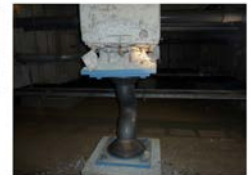
鉛ダンパーの定着部が破壊
