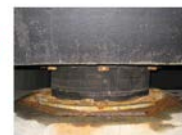
支承の鋼材部分のさび
